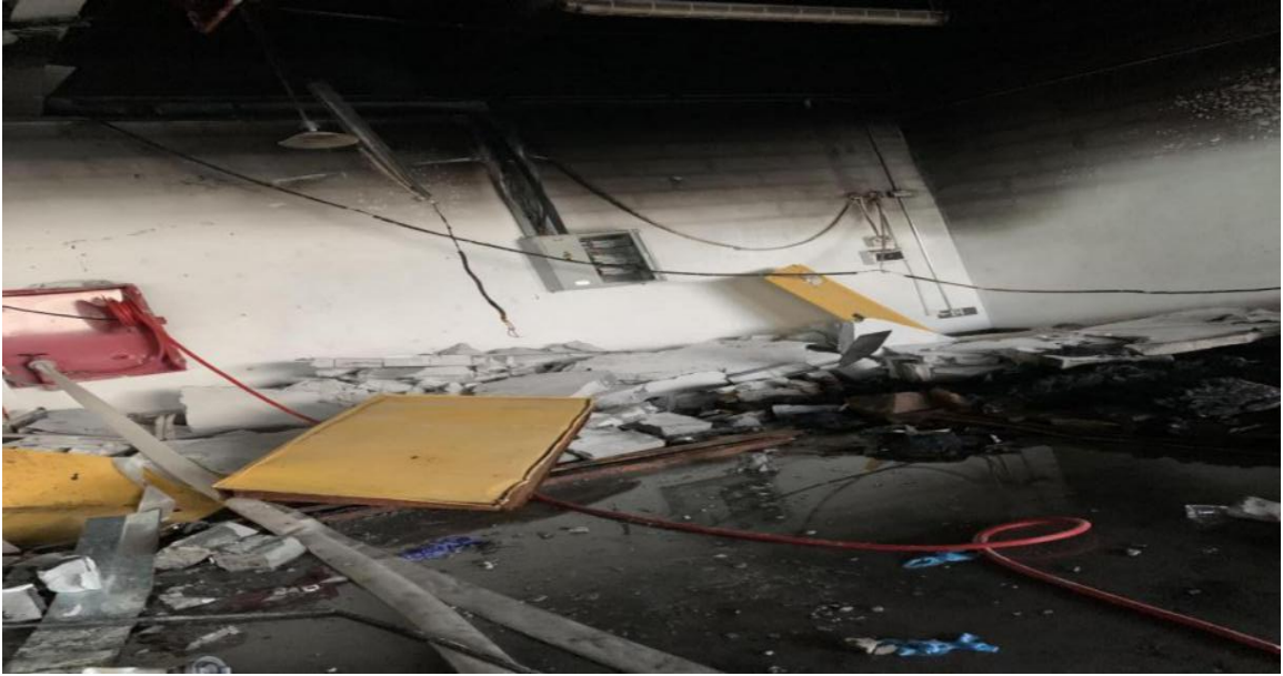
(图 4, 5 楼北部破坏现场照片)
