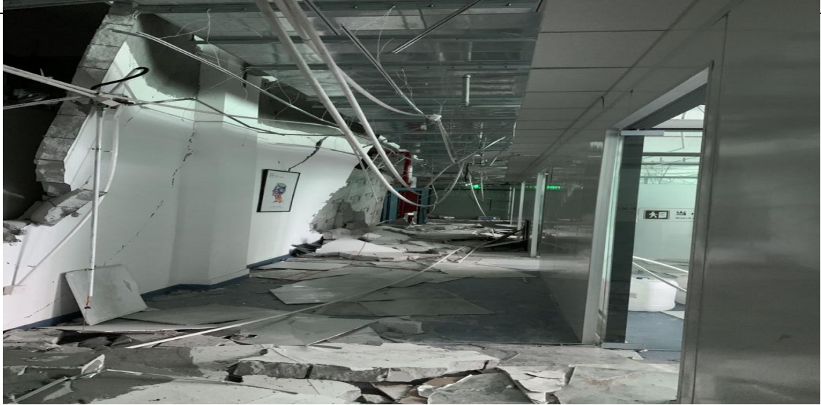
(图8, 制膜车间隔墙及吊顶等其它部位遭到破坏)
